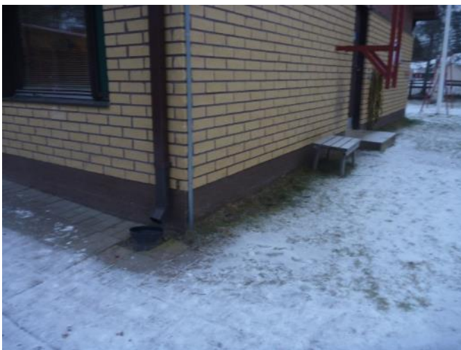
Kuva 5. Kattosadevedet on ohjattu sadevesikaivoihin.
