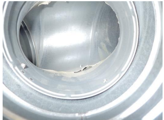
Kuva 2. Poistoilmakanava mustikan puolella. Kanavan sisäpinnalla lievästi pölyä.
