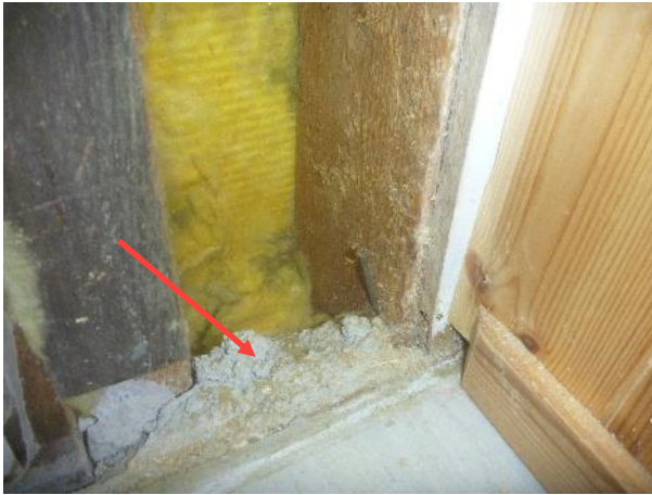
Kuva 20. RA2. Lattiabetoni on pursonnut seinärakenteen sisään. Rakenneavauksessa lievä tunkkainen hajua.
