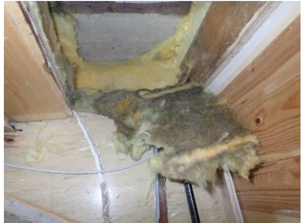
Kuva 13. RA1. Betonia vasten oleva villa tummunut. Villassa on voimakas haju.
