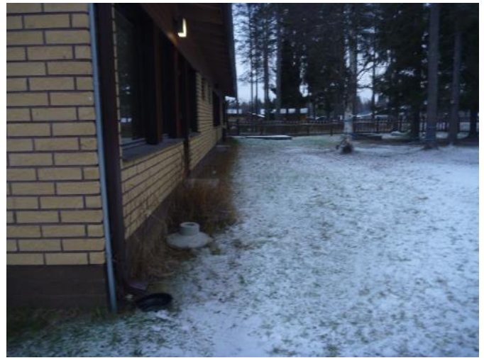
Kuva 4. Kuva rakennuksen takasivulta. Piha-alueen kallistus on tasainen. Rakennuksen vierellä on istutuksia, jotka osaltaan lisäävät kosteuskuormaa rakennuksen vierellä.
