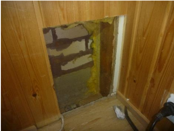
Kuva 12. RA1. Yleiskuva seinärakenteesta. Tiilimuurauksen laasti on pursonnut villatilaan. Rakenneavauksessa voimakas haju.
