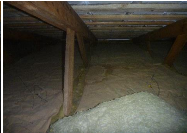
Kuva 36. Yleiskuva yläpohjatilasta. Mineraalivillan pinnalla on tuulensuojapaperi. Paperin pinnalla on yleisesti kosteusjälkiä.
