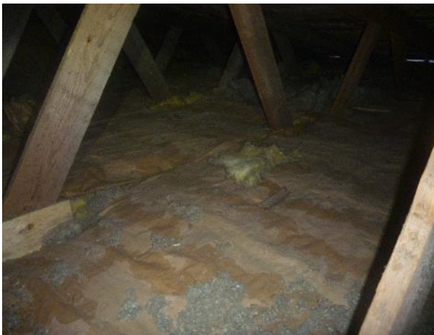
Kuva 37. Eristeen pinnalla on yleisesti kosteusjälkiä.
