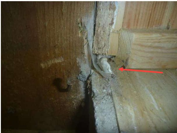
Kuva 14. RA1. Höyrynsulkumuovin ja lattian liittymää on tiivistetty liimamassalla. Havaintojen mukaan liittymä ei ole tiivis.
