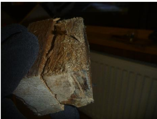
Kuva 22. RA2. Alaohjaukseen sivupinta on tummunut ja alkanut lahota. Näyte M3 alaohjaukseen pinnalta.
