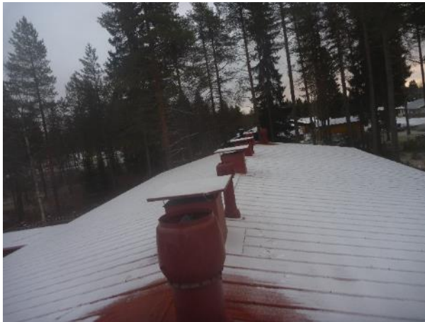
Kuva 29. Yleiskuva vesikatosta. Tarkastushetkellä katolla oli ohut lumikerros. Vesikatolla ei ole kulkusiltoja eikä lumiesteitä. Vesikatolla on vanhoja ja uusia ilmanvaihto hormoneja.
