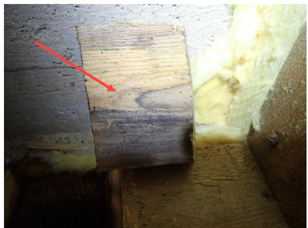
Kuva 17. RA1. Alaohjauspuun alapinnalla on kosteusjälkiä.
