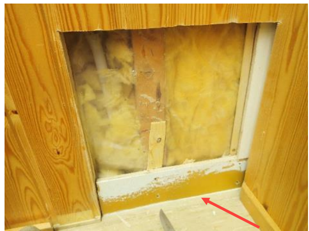
Kuva 23. Rakenneavaus RA4. Lattian rajaan asennettu ulkoseinälle vanerilevykaista joka tiivistetty liimamassalla. Liimamassalevyn ja lattian liittymässä ei tiivistä rakennetta.
