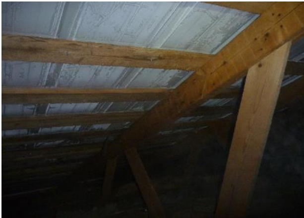
Kuva 35. Yleiskuva yläpohjatilasta. Vesikatteen alla ei ole aluskatetta. Pellin alapinta kuurassa pakkasilmalla. Kuuran sulaessa vesi aiheuttaa kosteusrasitusta yläpohjaan.
