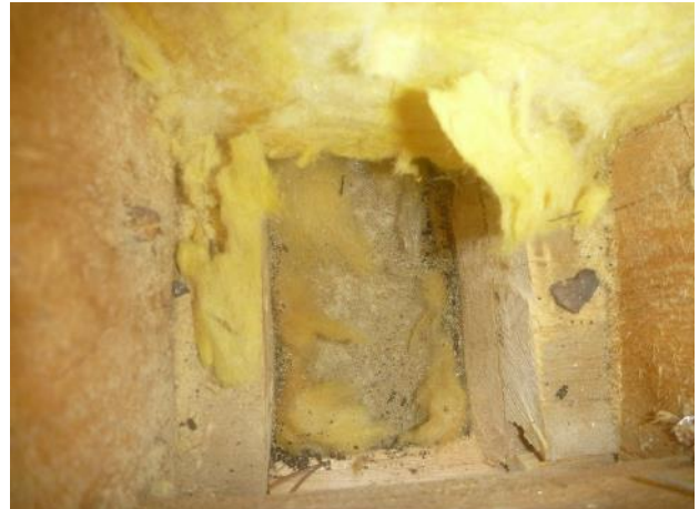
Kuva 25. RA2. Bitumikermin alla on mineraalivilla. Rakenneavauksessa on tunkkainen haju.
