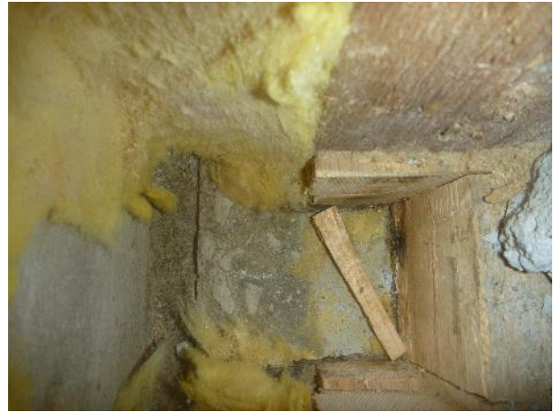
Kuva 21. RA2. Sokkelin yläpinnalla on kalkkihärmää, joka johtuu kosteuden noususta maaperästä. M4 otettiin alaohjaukseen alta.
