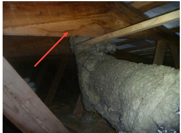
Kuva 32. Uusi ilmanvaihtohormi yläpohjatilassa. Vesikattorakenteissa havaittiin yleisesti kosteusjälkiä.
