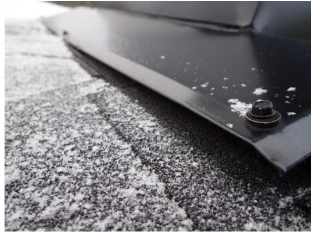
Kuva 50. Paikoin kateruuvit ovat irronneet.
