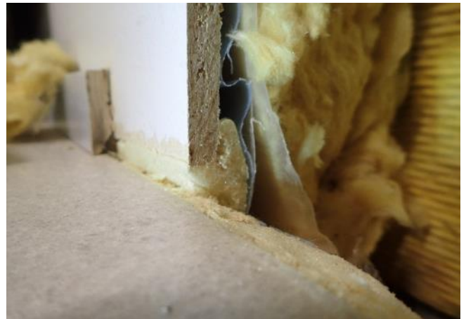
Kuva 33. RA2. Höyrinsulkumuovin ja betonin väli on tiivistetty uretaanilla. Uretaanimassa on kohtalaisen tiivis, mutta siinä on todennäköisesti ilmareittejä sisäilmaan.
