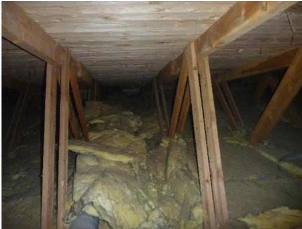
Kuva 51. Yleiskuva yläpohjatilasta. Yleisesti yläpohjan rakenteissa ei havaittavia vaurioita. Ilmanvaihtokanavien eristyksessä havaittiin yksittäisiä puutteita.
