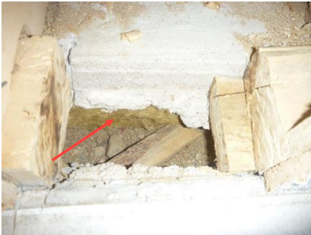
Kuva 45. RA3. Laatan alla puunkappaleita sekä alapohjaeriste villaa. Näyte M4 otettiin nuolen kohdalta.
