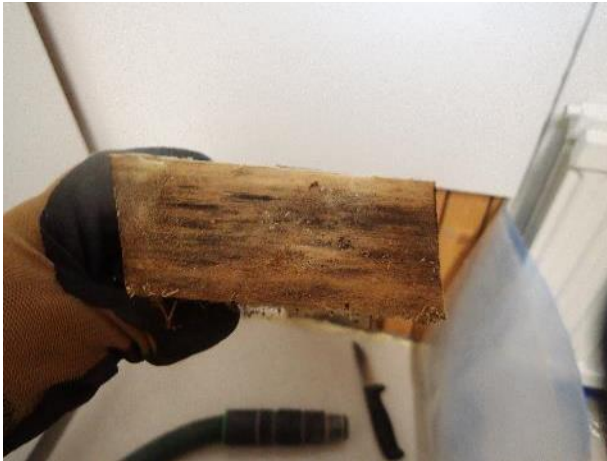
Kuva 30. RA2. Alaohjauspuun sivupinnalla on kosteusjälkiä.
