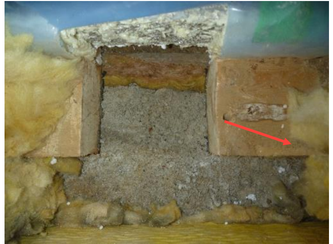
Kuva 37. RA4. Alaohjauspuun pinnalla on kosteusjälkiä. Materiaalinäyte M5 otettiin alaohjaupuun päältä (nuoli).
