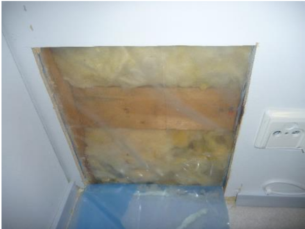
Kuva 18. RA1. Alaosaan lisätty sininen höyrynsulkumuovi, jonka alla on alkuperäinen kirkas höyrynsulkumuovi.
