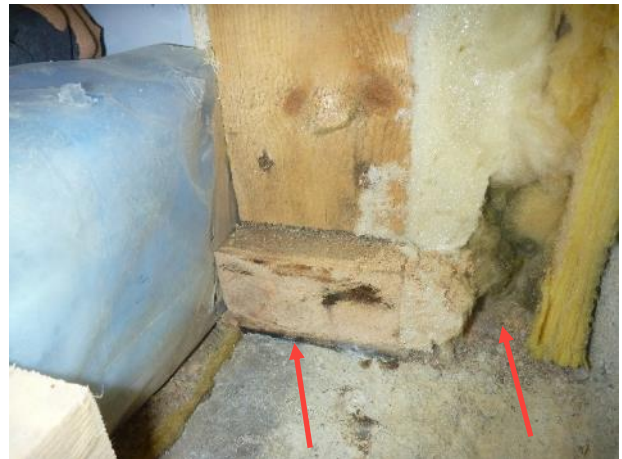
Kuva 21. RA1. Alaohjauspuun alla on bitumikermikaista. Koolauksen villa on kiinni betonin pinnassa.
