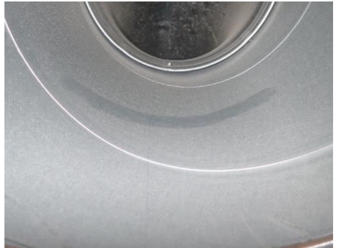
Kuva 2. Poistoilmakanava päiväkodin puolella. Kanavan sisäpinnalla lievästi pölyä.
