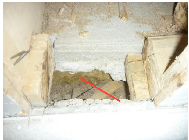
Kuva 11. RA3. Alapohjaeristeenä mineraalivilla. Näyte M4 otettiin nuolen kohdalta. Rakenneavauksessa tunkkainen hajua.
