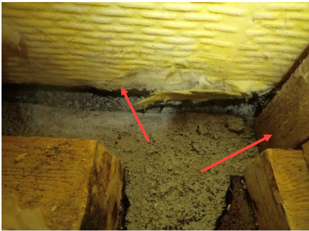
Kuva 32. RA2. Koolaus ja eristeet ovat kiinni betonin pinnassa. Rakennauksen kohdalla lievä tunkkainen haju.
