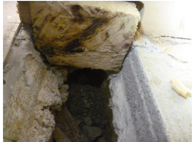
Kuva 46. Alaohjauspuu on painettu märkään betoniin rakennusvaiheessa. Rakenteesta on suora ilmayhteys sisäilmaan.
