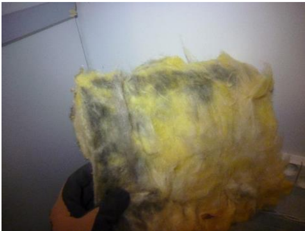
Kuva 20. RA1. Ulkoseinävillan ulkopinnalla on tummentumaa. Villassa on tunkkainen haju.
