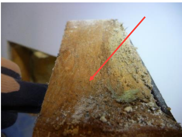
Kuva 22. RA1. Alaohjauspuun sivupinnalla on kosteusjälkiä. Näyte M1 nuolenkohdalta.
