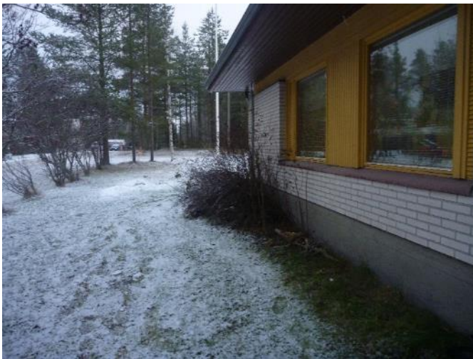
Kuva 5. Kuva rakennuksen päädystä. Sokkelin lähellä on istutuksia jotka lisäävät kosteutta rakennuksen vierellä.
