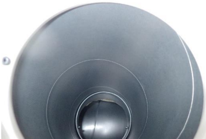
Kuva 1. Tuloilmakanava esikoulun puolella. Kanavan sisäpinnalla ei ole näkyvää pölyä.
