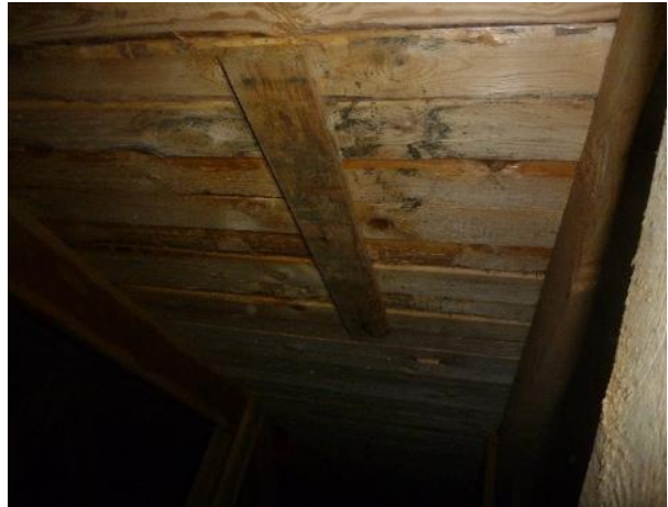
Kuva 52. Paikoin laudoituksen pinnalla havaittiin kosteuden aiheuttamaa sinistymää.
