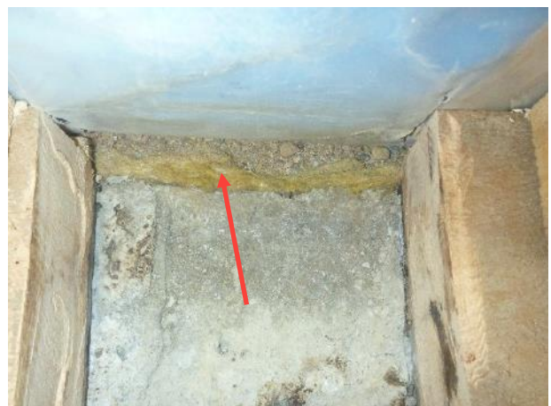
Kuva 23. RA1. Sokkelin sisäpinnassa on lämmöneristeenä mineraalivilla. Villa vaurioituu herkästi maaperän kosteuden vaikutuksesta.
