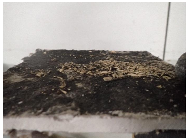
Kuva 29. Kipsilevyn sokkelin vastainen pinta täynnä mikrobikasvustoa.
