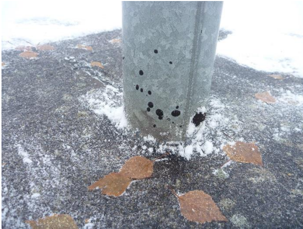
Kuva 44. Osa vesikaton läpivienneistä toteutettu ilman läpivientikauluksia.
