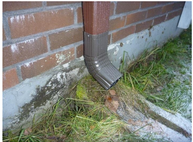
Kuva 6. Sokkelissa kosteusjälkiä syöksyn kohdalla.
