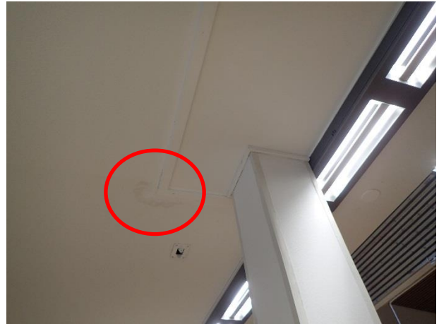
Kuva 39. Vanha kosteusjälki katossa kirjastosalin kohdalla.
