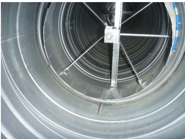
Kuva 1. Ilmanvaihtokanavissa pääosin vain vähän pölyä.
