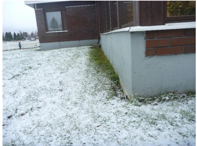
Kuva 8. Maanpinta kallistuu nurkkaa kohti, jossa maali hilseillyt.
