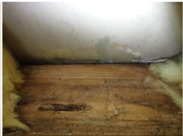
Kuva 17. Alaohjauspuussa ja kipsilevyssä pintahometta.
