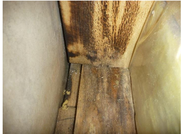
Kuva 25. RA4, Alaohjauspuussa kosteusjälkiä.
