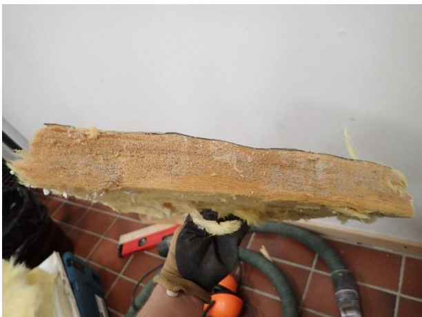
Kuva 22. Ulkoseinän eristevillassa kosteutta.
