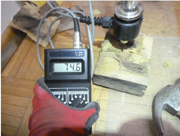
Kuva 26. RA2, Alaohjauspuun alapinnan kosteus 74,6 p% (raja-arvo 15 p%).
