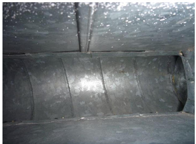
Kuva 2. Tuloilmakanavan yläreunassa hieman pölykertymää.
