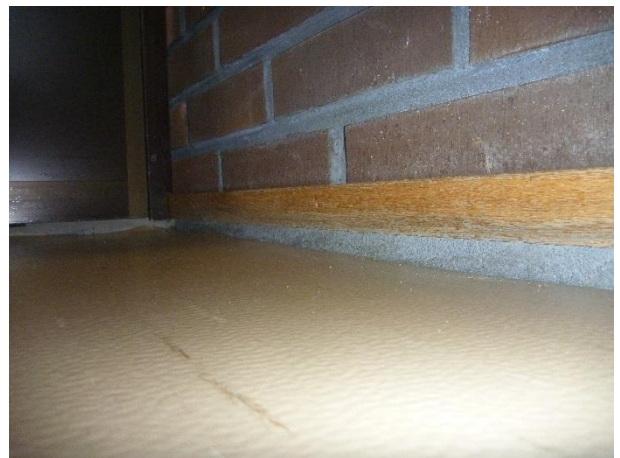
Kuva 13. Alapohjalaatta painunut eteisessä.
