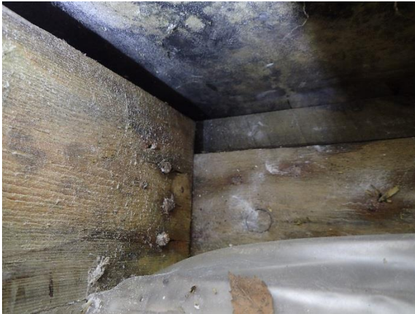
Kuva 30. RA5, Runkotolppa, alaohjauspuu ja kipsilevy kosteusvaurioituneet.
