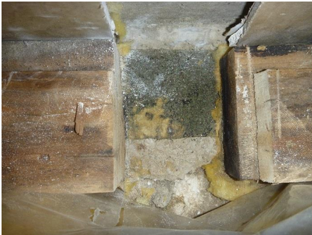
Kuva 32. RA4, alaohjauspuun alla villakaistale. Bitumikermi vain osittain alaohjauspuun alla.
