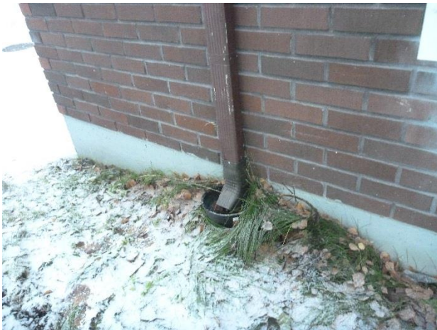
Kuva 5. Syöksy ja sadevesikaivo seinässä kiinni.
