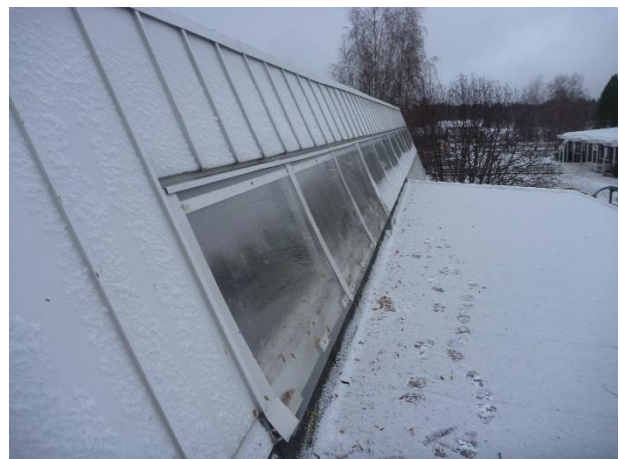
Kuva 37. Sisäänpäin kallistuvat ikkunat on suojattu muovilevyillä.
