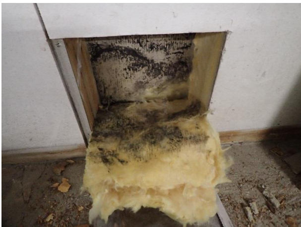
Kuva 28. RA5, Villassa ja kipsilevyssä kosteusvaurio.
