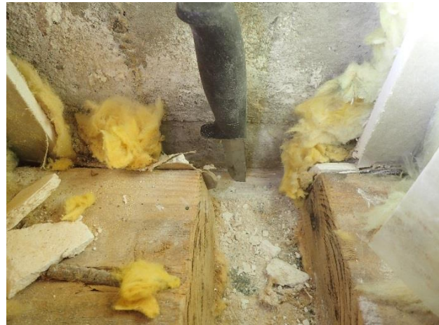
Kuva 21. Muottilaudoitus jätetty sokkeliin.
