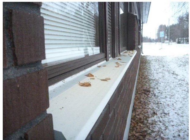
Kuva 35. Ikkunapeltien kallistus hyvin loiva.
