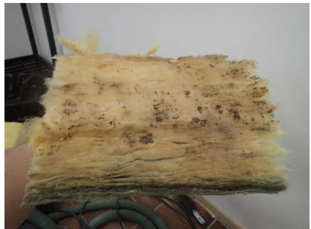
Kuva 23. Eristevillassa mikrobivaurioita, villa tiivistynyt kosteuden vaikutuksesta.
