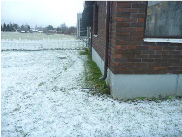
Kuva 7. Syöksyt laskevat enimmäkseen betonisiin loiskekouruihin. Sokkelin maali hilseilee.
