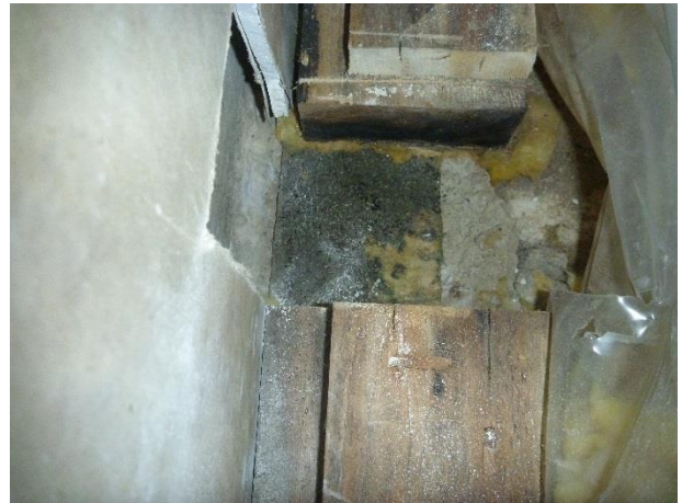
Kuva 33. RA4, alaohjauspuu pahoin kosteusvaurioitunut.
