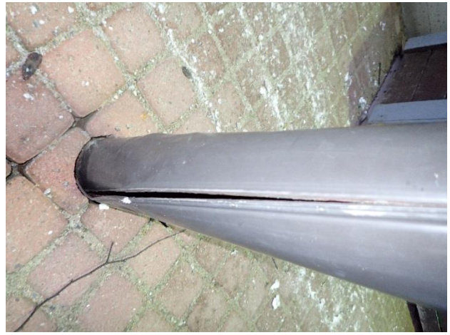
Kuva 6. Etupihalla syöksyputki haljennut.
