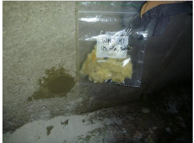
Kuva 14. Ulkoseinän lämmöneristeestä otettu mikrobinäyte M1.
