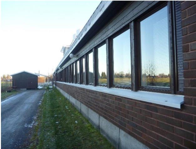
Kuva 3. Kuva rakennuksen takapihalta. Kallistus loivasti rakennuksesta poispäin. Sokkelin alareunassa kosteuden jälkiä.
