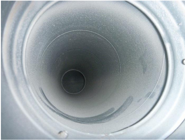
Kuva 1. Tuloilmakanavaan kertynyttä pölyä.
