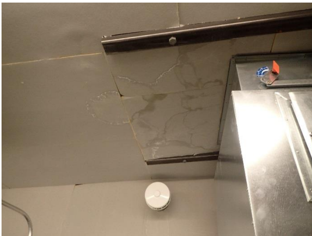
Kuva 28. IV-konehuoneen katossa kosteusjälkiä.
