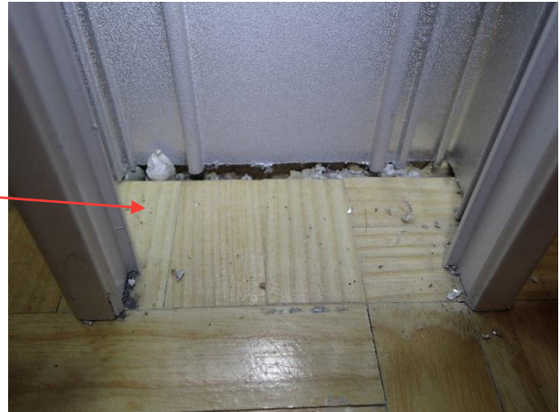
Kuva 17. Sähkökotelon alareuna tiivistämättä kokonaan. Kotelon kohdalla voimakas mikrobilähteeseen viittaava hajuu.
