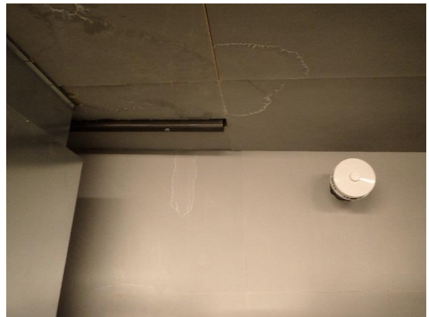
Kuva 29. IV-konehuoneen katossa ja seinällä kosteusjälkiä.
