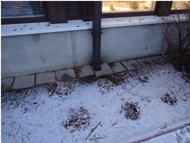
Kuva 5. Sadeveisisyöksy aivan seinän vieressä.
