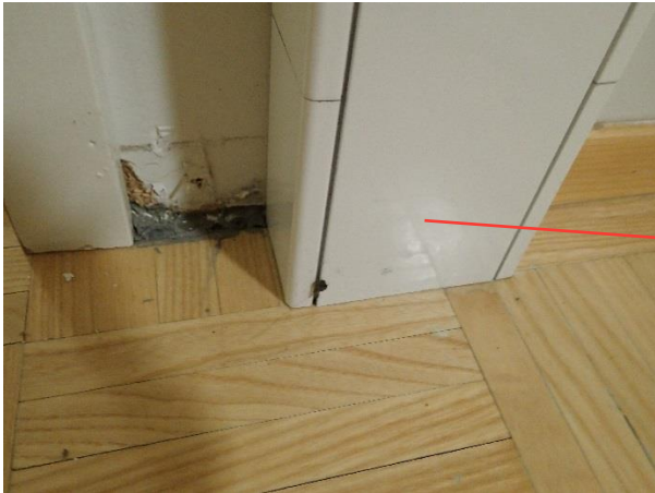
Kuva 16. Salin lattialistan takana oleva tiivistysmassaus.
