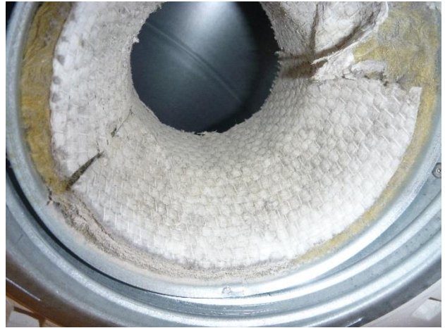
Kuva 2. Poistoilmakanavan mineraalivillainen äänenvaimennuselementti.
