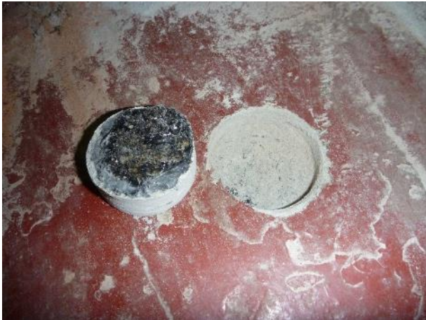
Kuva 29. RA9. Pintavalun alla on bitumimassa.
