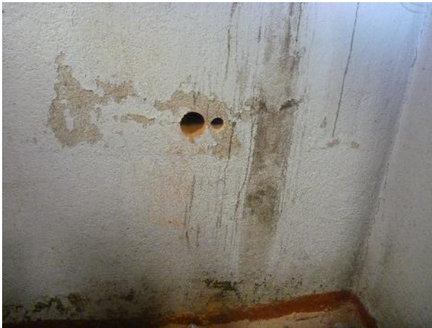
Kuva 48. Rakenneavauksen RA10 kohta pannuhuoneen ulkoseinässä maanpinnan alapuolella. Rakenneavauksessa tunkkainen haju.
