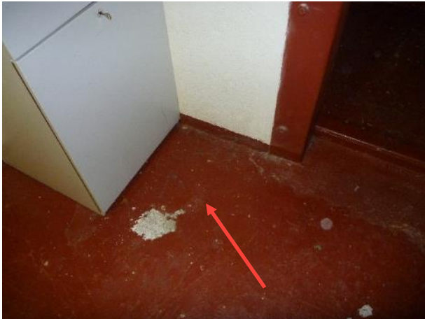
Kuva 31. RA11. Rakenneavaus väestönsuojan lattiaan tehtiin oven vierelle. Kohdalla lattian pintakosteus on koholla.
