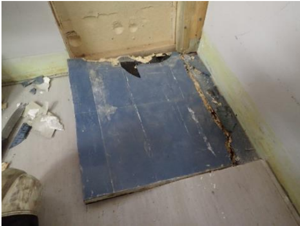
Kuva 11. RA1. Kipsilevyn alla on vinyylilaatta ja lastulevy. Musta liima ja laatta sisältää asbestia.
