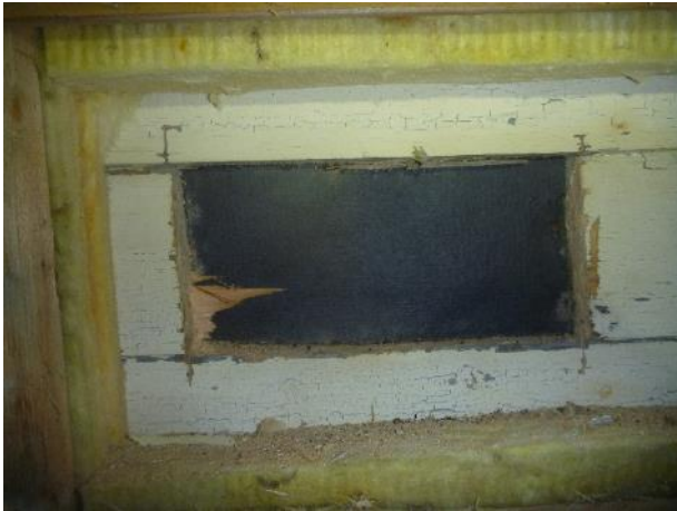
Kuva 56. RA14. Lisälämmöneristyksen takana on alkuperäinen ulkoveriverhous. Ulkoveriverhousen takana on tuulensuojapaperi. Paperi sisältää runsaasti PAH-yhdisteitä.
