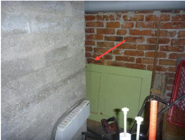
Kuva 50. Rakenneavauksen RA12 kohta kellarin ulkoseinässä portaiden alla. Rakenneavauksessa tunkkainen haju.
