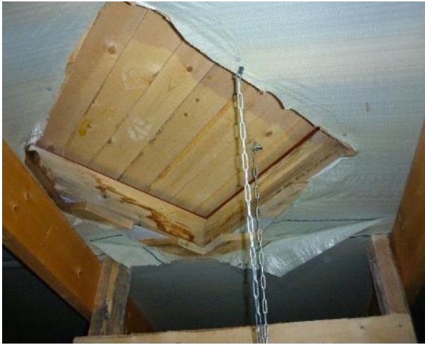
Kuva 99. Aluskate on asennettu puutteellisesti.
