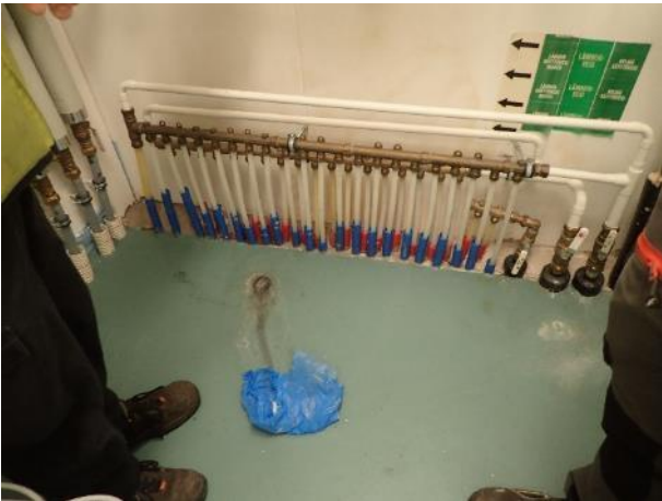
Kuva 88. Laajennuksen lämmönjakohuoneessa lattiakaivo on tukittu. Lattian vesieristystä ei ole nostettu seinälle.
