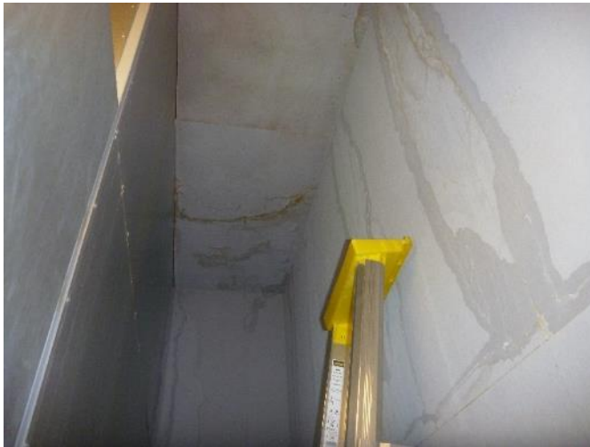
Kuva 1. Ilmastoinnin konehuoneen seinä ja kattopinnoilla havaittiin paikoin kosteusjälkiä.
