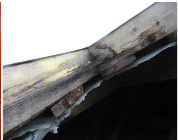
Kuva 98. Yläpohjan kulkuluukun reunoilla on kosteusjälkiä.
