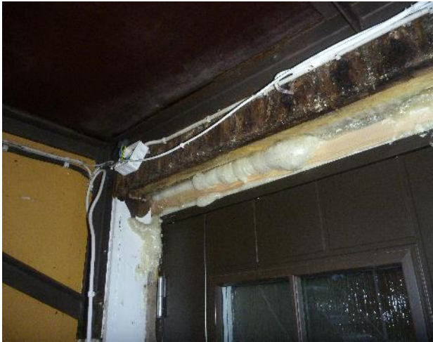
Kuva 82. Lattivanerin päälle satava vesi on kastellut seinärakenteen.
