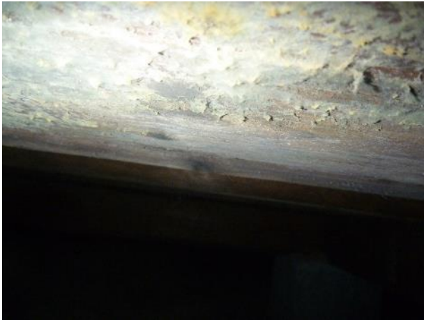
Kuva 23. RA6. Alapohjarungon pinnalla homekasvustoa.
