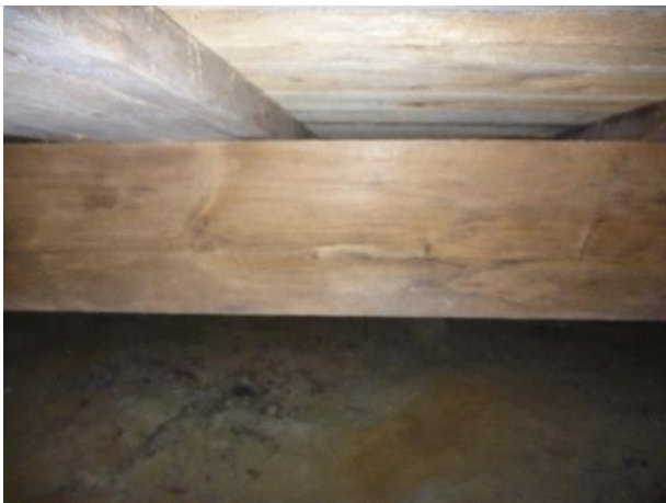
Kuva 25. RA6. Alapohjarungon pinnalla kosteusjälkiä ja vähäistä kasvustoa.
