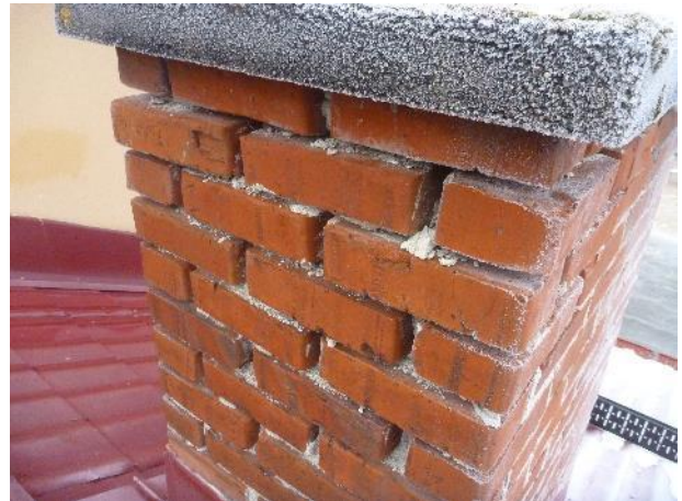
Kuva 70. Tiilen kiinnityslaasti on irronnut ja tiilit ovat osin irti. Muuraus suositellaan korjattavaksi ensitilassa.
