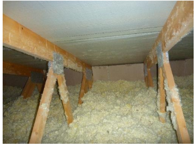
Kuva 100. Kuva yläpohjasta räystäsalueelta. Räystäät ovat umpinaiset eikä yläpohja tuuletu.
