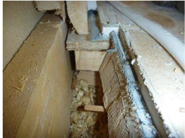
Kuva 66. RA7. Ulkoseinän ja välipohjan liittymä ei ole tiivis.
