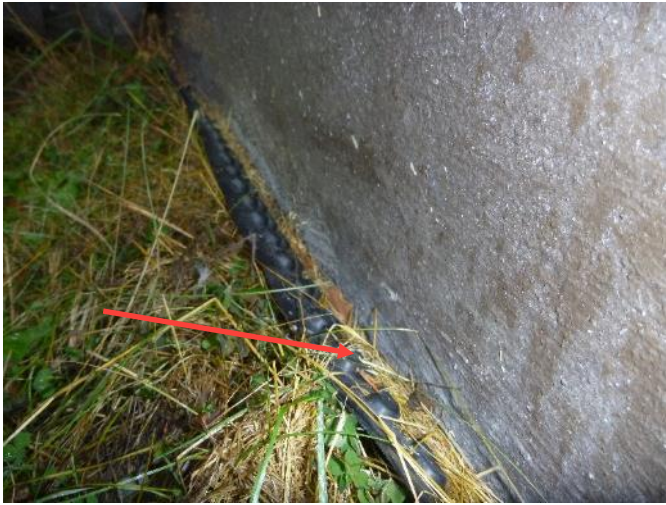
Kuva 8. Patolevyn yläreunassa ei ole tiivistyslistaa.
