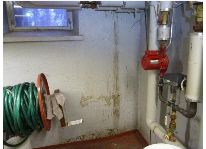
Kuva 77. Kellarin seinän sisäpinnan tasoite ja maali sisältävät asbestia krysotiili ja antofylliitti.
