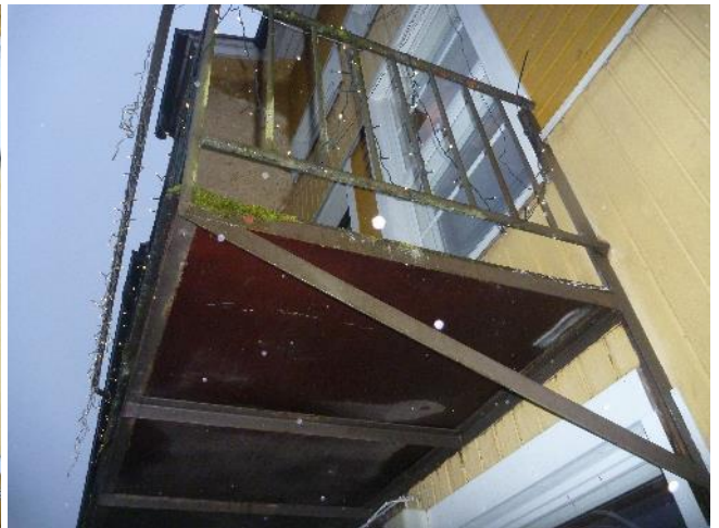
Kuva 81. Lattiavaneri on pehmentynyt vesisateen ja lumensulamisen vaikutuksesta.
