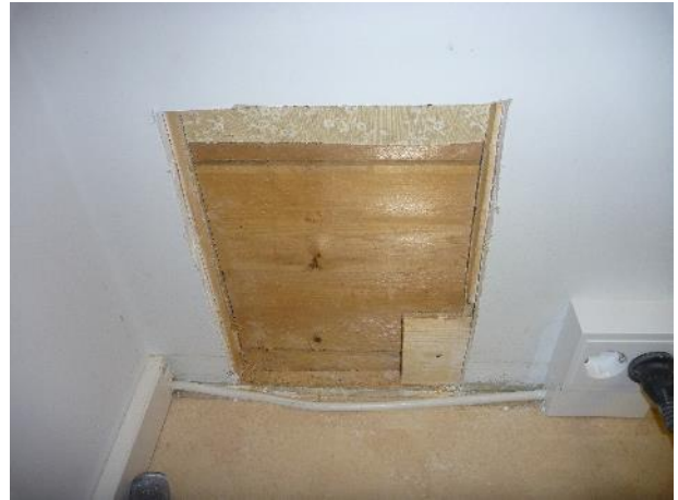
Kuva 43. RA7. Kipsilevyn takana vanha sisäverhouslevy ja umpilaudoituus.
