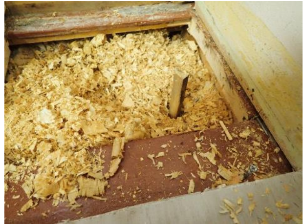
Kuva 12. RA1. Lastulevyn alla on alkuperäinen lautalattia. Lämmöneristeenä on kutterinpuru.
