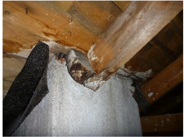
Kuva 74. Hormien juurilla on kosteusjälkiä. Jäljet ovat arviolta vanhoja.
