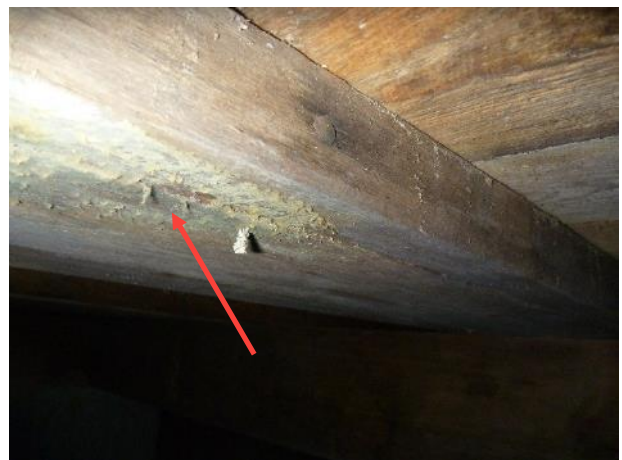
Kuva 22. RA6. Alapohjarungon pinnalla homekasvustoa ja lahoa.
