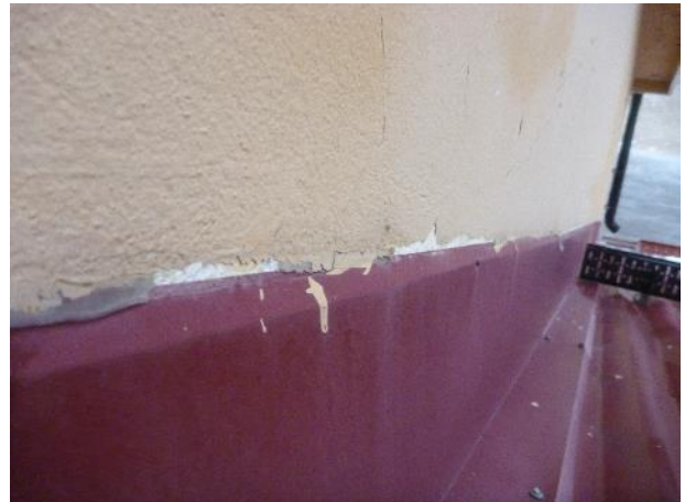
Kuva 68. Seinänostopellin sauma ei ole tiivis seinäpintaan.
