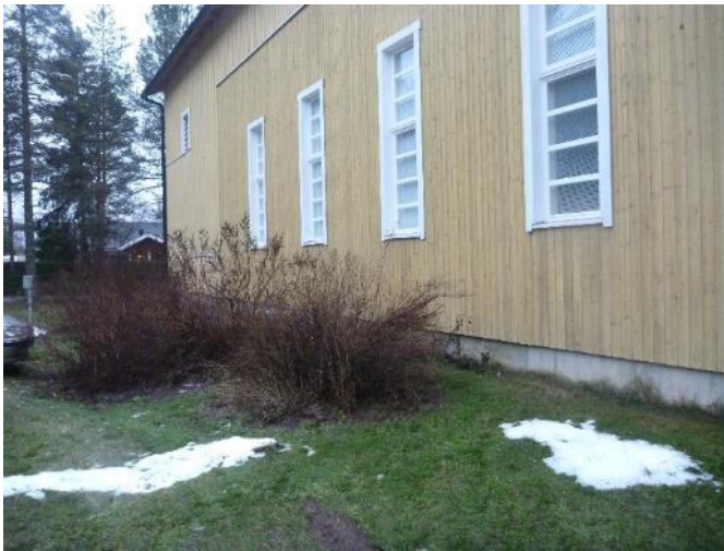
Kuva 84. Kuva rakennuksen etusivulta. Rakennuksen vierustalla on istutuksia, jotka lisäävät kosteusrasitusta rakenteille.
