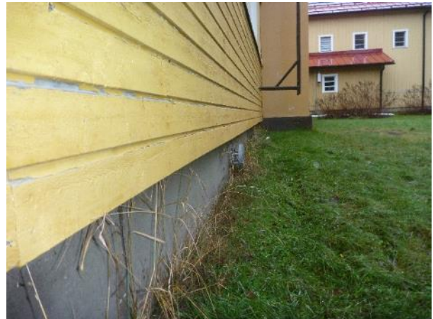
Kuva 59. Kuva vanhan osan ulkoveriverhousesta. Maalipinta hilseilee paikoin.
