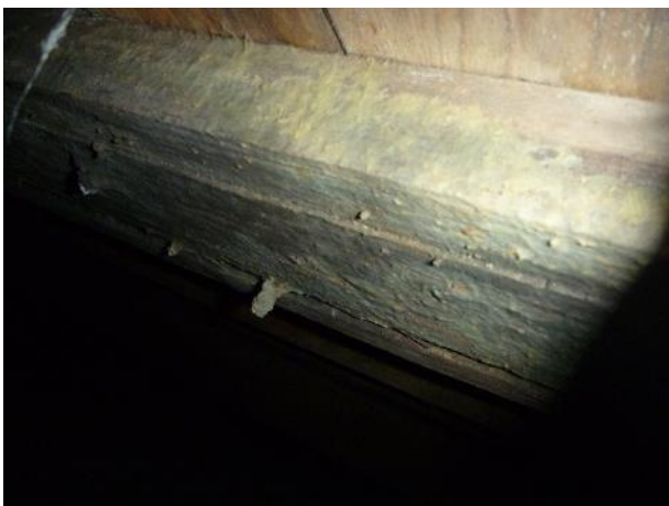
Kuva 21. RA6. Alapohjarungon pinnalla homekasvustoa.
