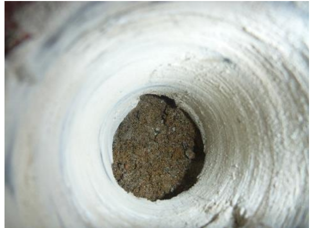
Kuva 30. RA9. Betonilaatan alla ei ole lämmöneristettä. Laatan alla oleva hiekka / moreeni maa on märkää.
