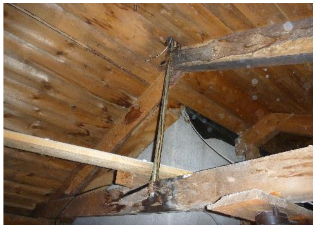
Kuva 72. Antennin läpiviennin ympärillä on veden valumajälkiä.
