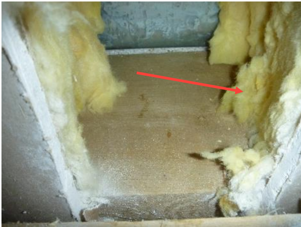
Kuva 93. RA15. Alaohjapuuna on painekyllästetty lankku. Näyte M8 otettiin nuolen kohdalta.
