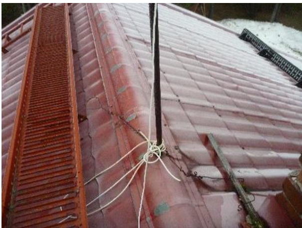
Kuva 71. Antennin läpiviенти ei ole tiivis.
