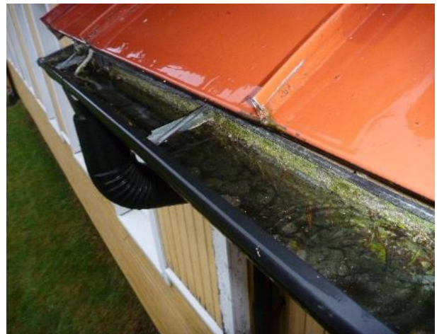
Kuva 96. Räystäskourut ovat roskaiset ja osin jäässä.
