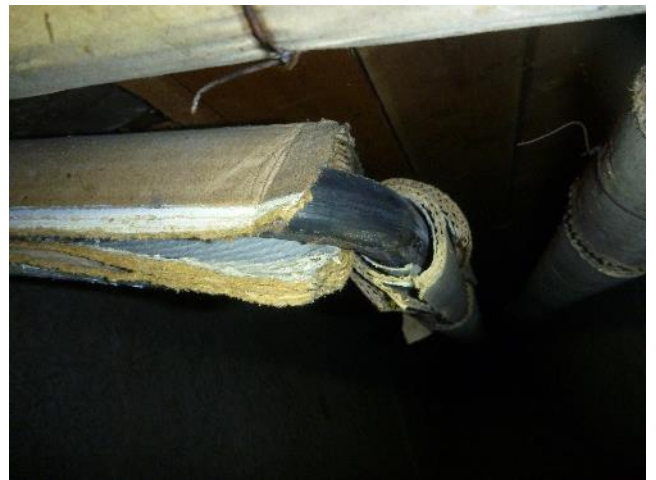
Kuva 79. Putkikanaalissa olevat putkieristeet.
