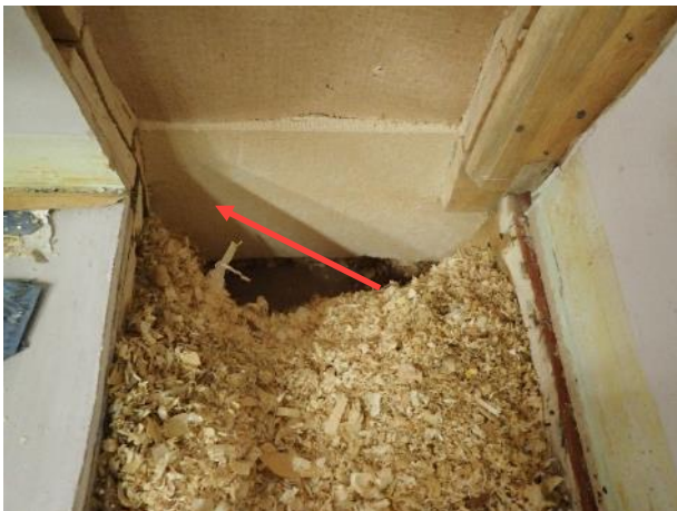
Kuva 13. RA1. Ulkoseinän ja al pohjan liittymän kautta sisäilmaan voi kulkeutua epäpuhdasta ilmaa. Avauksen kohdalla ei havaittu poikkeavaa hajua.
