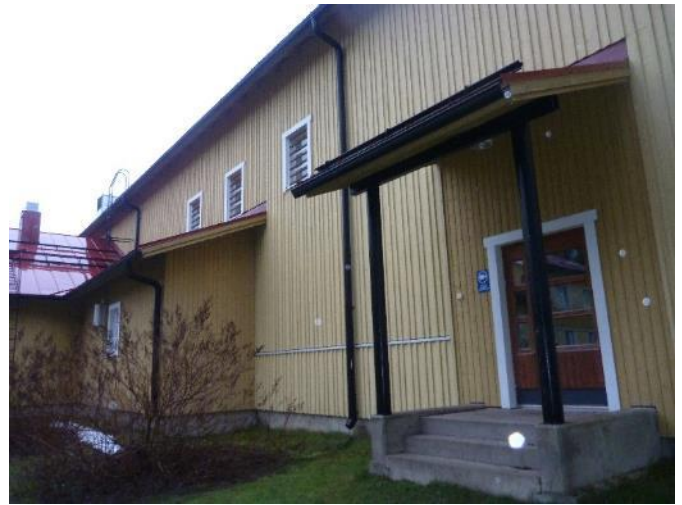
Kuva 85. Kuva rakennuksen takasivulta. Piha-alueen kallistus on loiva ja paikoin tasainen. Rakennuksen vierustat ovat nurmipintaiset.
