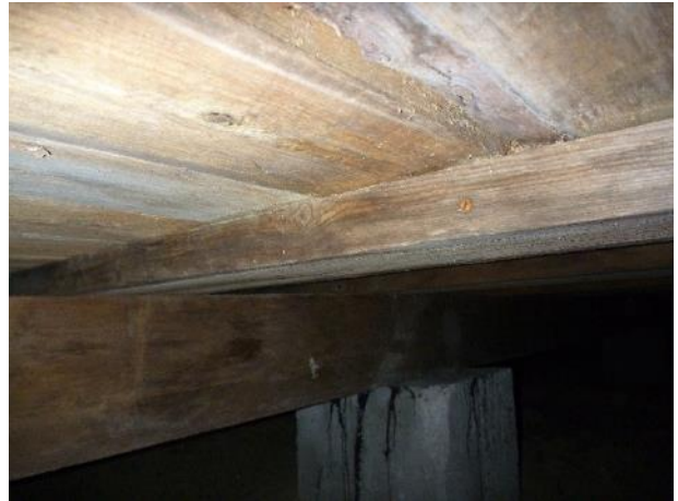
Kuva 24. RA6. Alapohjarungon pinnalla kosteusjälkiä ja vähäistä kasvustoa.
