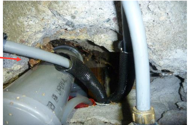
Kuva 64. Läpivienti ei ole tiivis.
