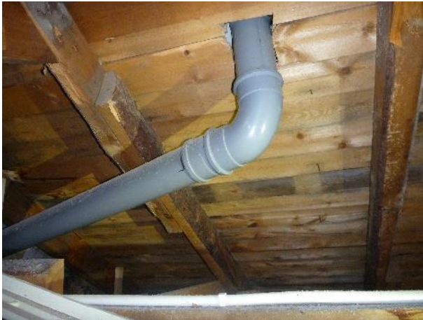
Kuva 75. Yläpohjassa on eristämätön ja kannakoimaton viemärintuuletusputki.
