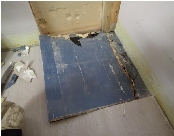
Kuva 76. Lattian vanha sininen vinyylilaatta ja musta liima sisältää asbestia krysotiili.
