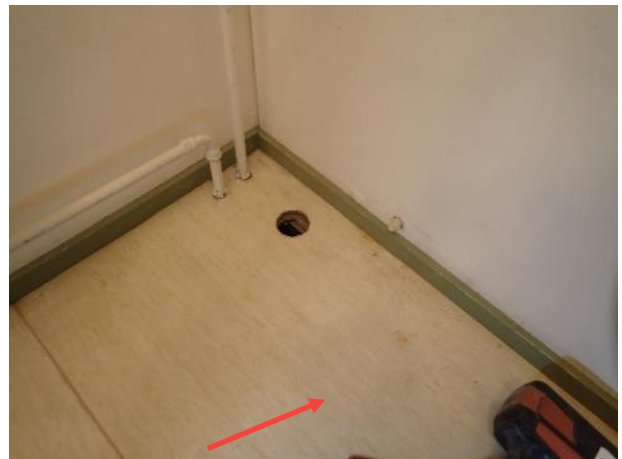
Kuva 14. Rakenneavaus RA3 tehtiin aulan 117 lattiaan putkikanaalin yläpuolelle porauksella. Kohdalla havaittiin lattian taipumista jalan alla.
