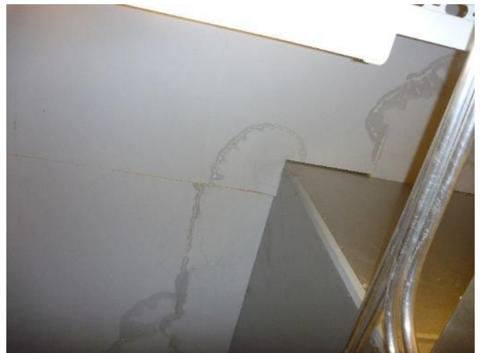
Kuva 2. Ilmastoinnin konehuoneen seinä ja kattopinnoilla havaittiin paikoin kosteusjälkiä.
