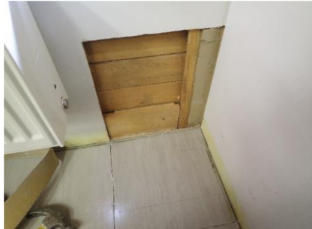
Kuva 35. RA1. Sisäverhouslevytyksen takana on puukoolaus ja umpilaudoitus. Höyrynsulkua ei ole, rakenne ei ole ilmatiivis.
