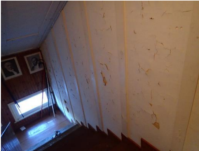
Kuva 3. Ullakon portaikossa mineraavilla eristeitä joista kuituja voi päästä sisäilmaan.
