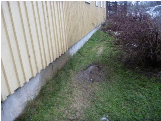
Kuva 86. Kuva laajennuksen sivulta. Räystäskouru vuotaa ja vesi valuu maahan ja kastelee sokkelirakennetta.
