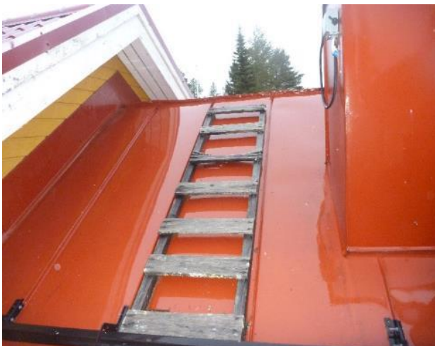
Kuva 97. Lapetikkaat ovat lahonneet.
