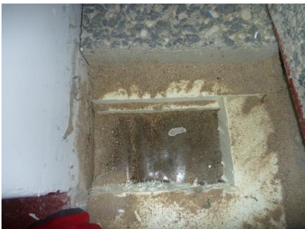
Kuva 33. Osa väestönsuojan lattiasta on tehty betonilaatalla. Laatan alla XPS-solumuovieriste, rakennusmuovi ja täyttömaa.
