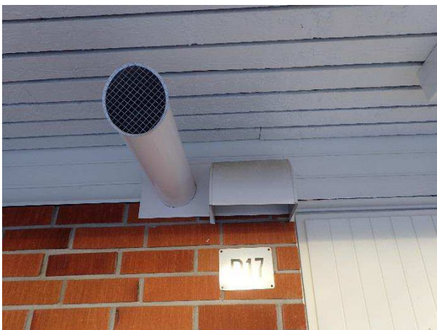
Kuva 9. Ilmanvaihdon tulo- ja poisto vierekkäin, aiheuttaa tulo/poistoilman sekoittumisriskin.
