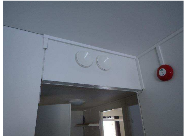
Kuva 4. IV-kanavan venttiilit ovat puhtaat.
