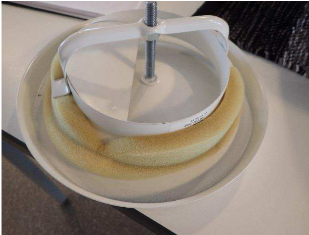
Kuva 3. IV-kanavan päätelaitteet ovat puhtaat.
