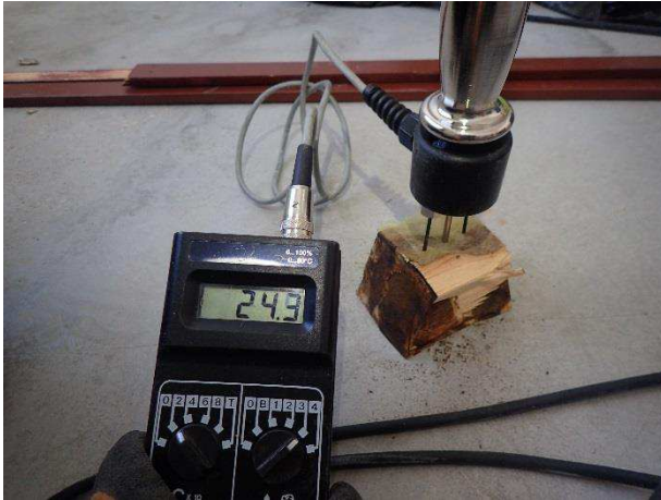
Kuva 34. RA4, Alaohjauspuun kosteus kohonnut.
