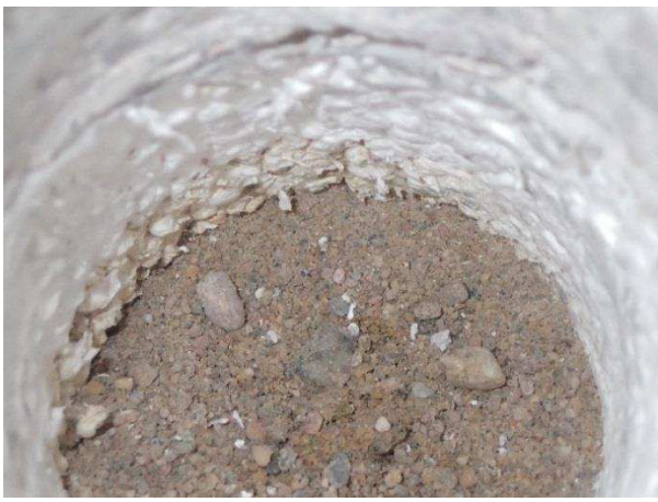
Kuva 17. RA5, Lämmöneristeen alla oleva hiekkatäyttö on kuiva.
