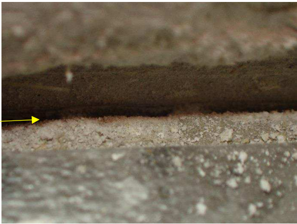
Kuva 15. Alapohjan liitos ei ole tiivis.
